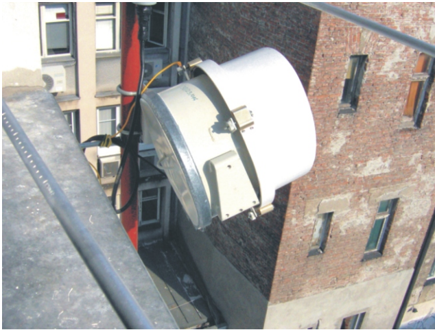
Instalirana ODU jedinica sa antenom 0.3m
